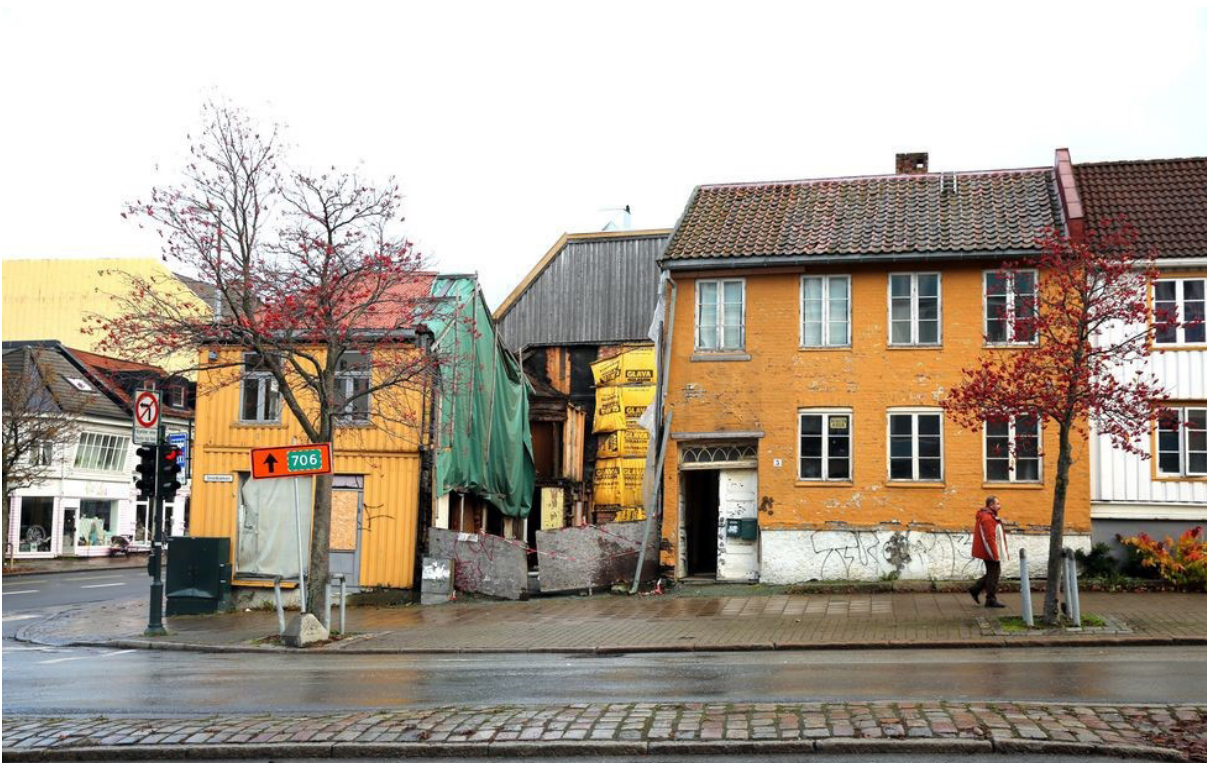
01 Die Fassade des Wohnhauses Smedbakken 5 in Trondheim von 1846: ca. 40 Jahre alte dampfdiffusionsdichte Anstriche und sichtbare bauphysikalische äußere Schäden durch eine gestörte Mikro-Meteorologie: Frostsprengungen, Risse und Abblättern des Anstrichs (Quelle: Adresseavisen)
