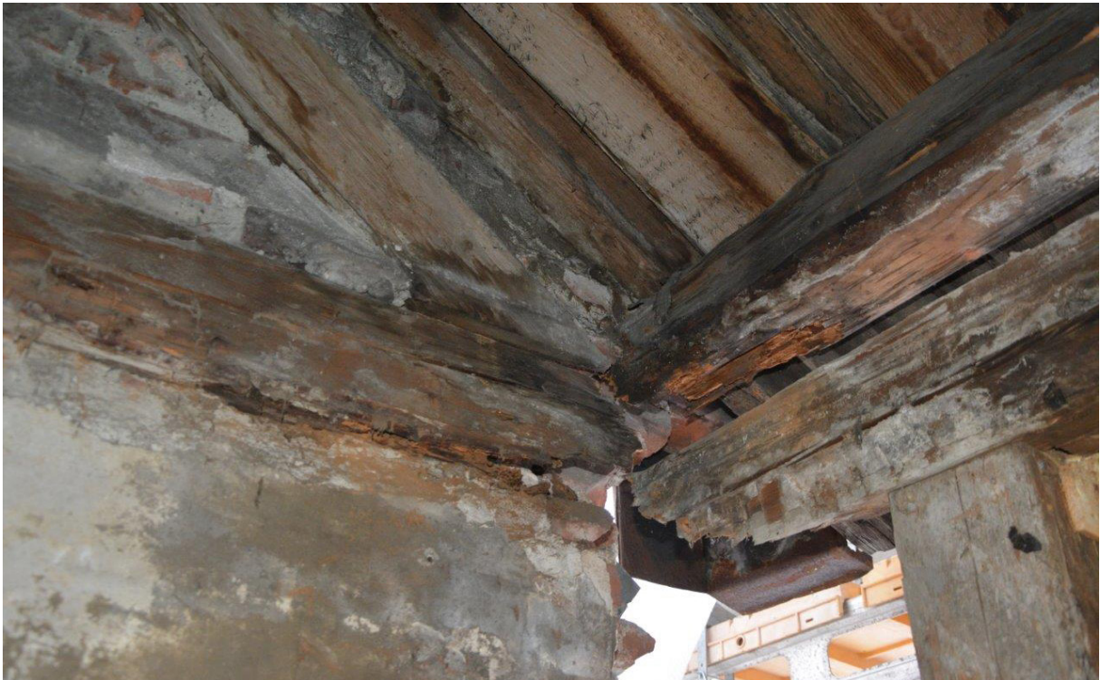
02 Enorme konstruktive Schäden an allen geometrischen Umhüllungen des 175 Jahre alten Wohnhauses im Smedbakken 5 ca. 40 Jahre nach der mikro-meteorologischen Umkehrung der Dampfdurchlässigkeit und des T- Punktes. (Quelle: Autor)
